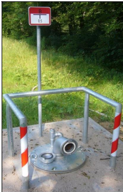
Abbildung 14: Löschwasserbrunnen mit Beschilderung
