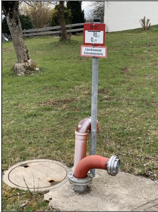
Abbildung 12: Unterirdischer Löschwasserbehälter mit einem Saugrohr und einem Lüftungsrohr in Amtzell
